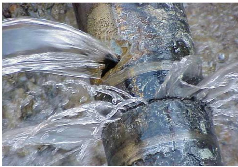
Рис. 4.30. Потери воды на магистральном водопроводе
